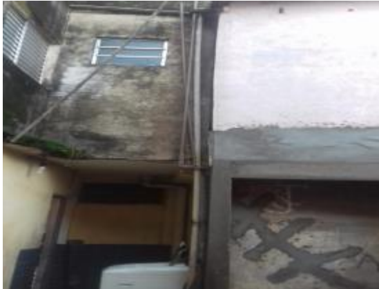
Rachadura remendada (Pedreira)
