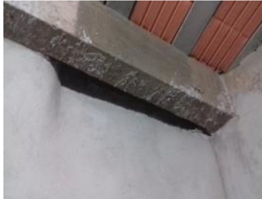
Viga mal posicionada (Pedreira)
